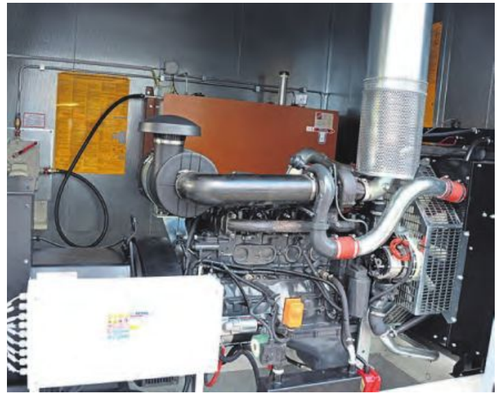
Blick in die Technik der 120 PS starken stationären Anlage.
