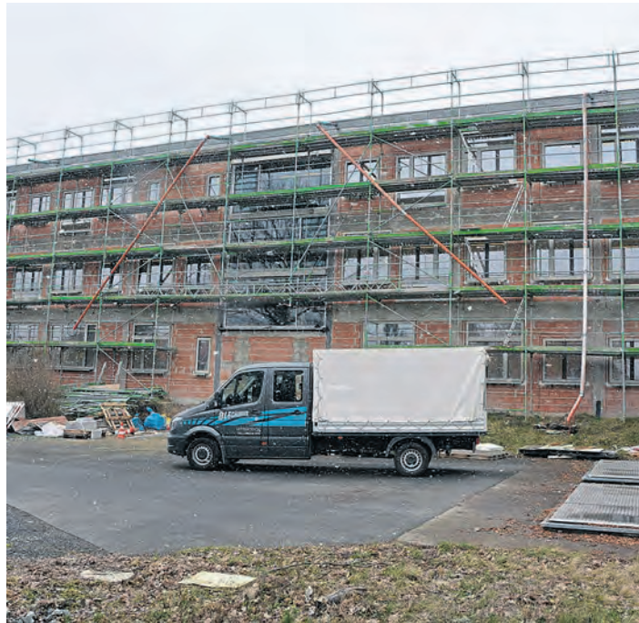
Die Außenansicht von den Parkplätzen her gesehen. Wenn das Wetter schöner wird, soll mit der Fassade begonnen werden. (jr)
